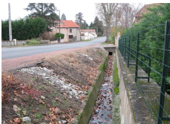
Fig. 25. Débordement du fossé en béton
